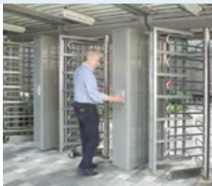
Entrada de personal: instalación múltiple en la zona exterior de una planta
