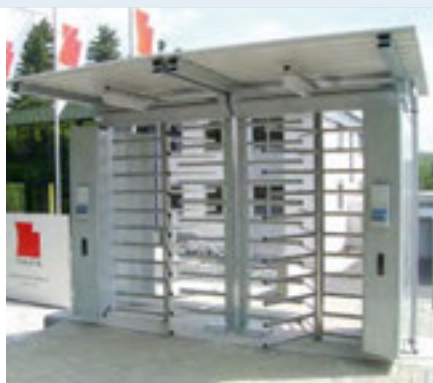
Instalación doble con cubierta, para una protección a la intemperie y contra intentos de acceso por alto
